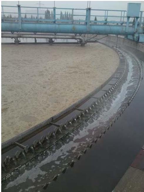
Nachklärbecken von China Everbright International in Jinan
